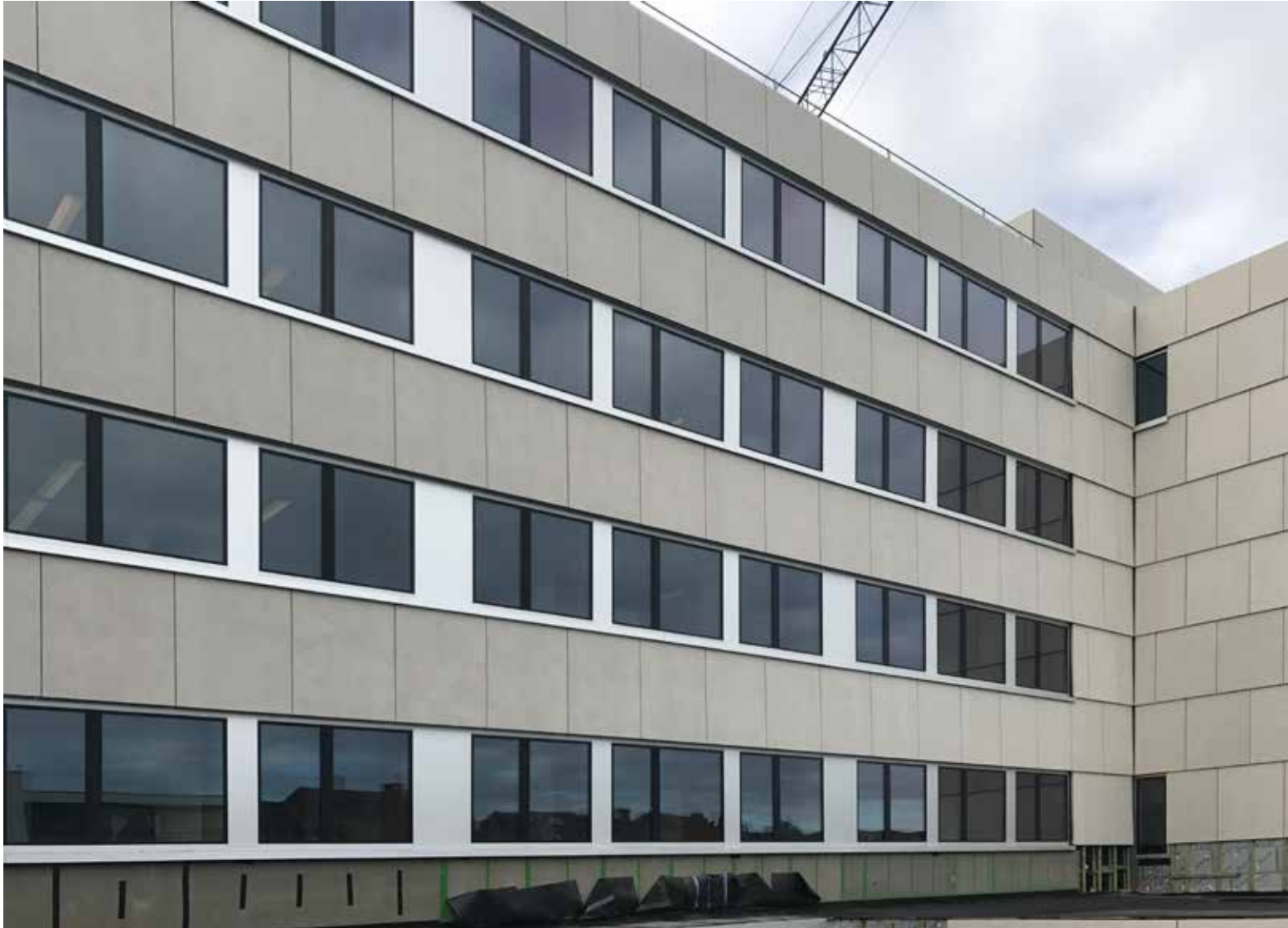
De bestaande betonnen prefabplaten zijn voorzien van stalen ankers, met daarop houtskeletbouw in caissons en de gevelbekleding.
